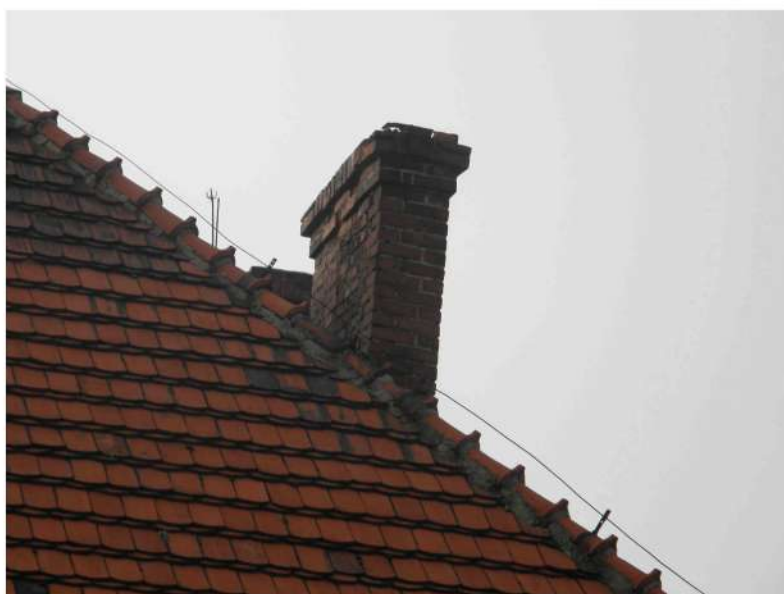
Foto nr 12 Budynek B – widok stanu technicznego komina
