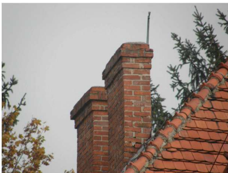
Foto nr 11 Budynek A – widok stanu technicznego kominów
